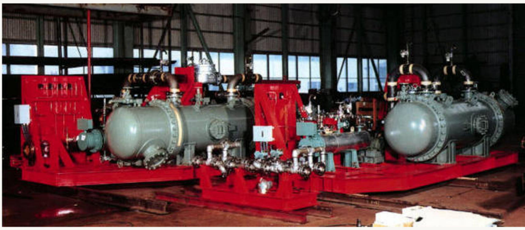
▲非常用発電設備補機ユニット
